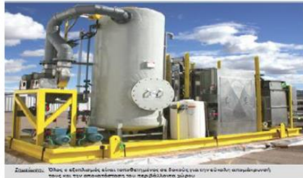
Συμπίεση: Όλος ο εξοπλισμός είναι κατασκευασμένος σε δοχεία για την εύκολη απομάκρυνσή τους και την αποκατάσταση του περιβάλλοντα χώρου.
